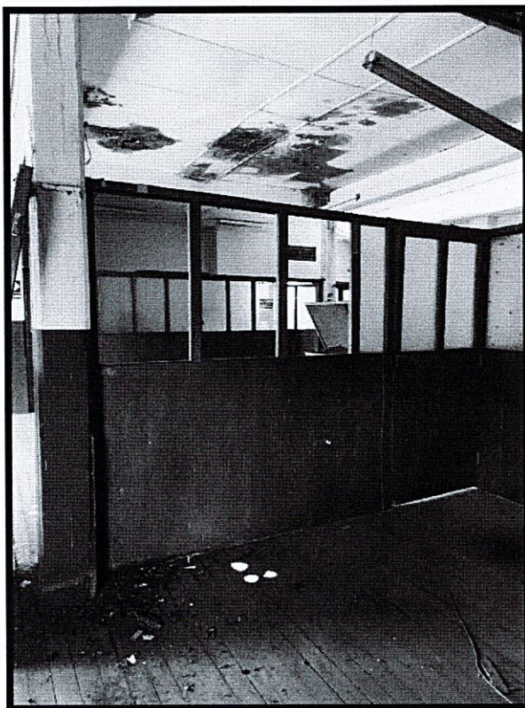
Foto 05. Cielo raso en mal estado a ser reparado.
