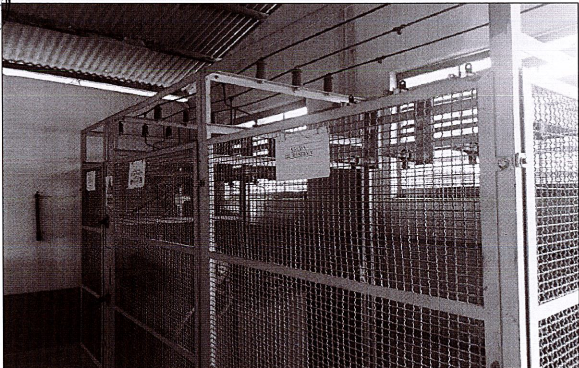
Equipos y barras de Media Tensión totalmente expuestos en peligro latente
