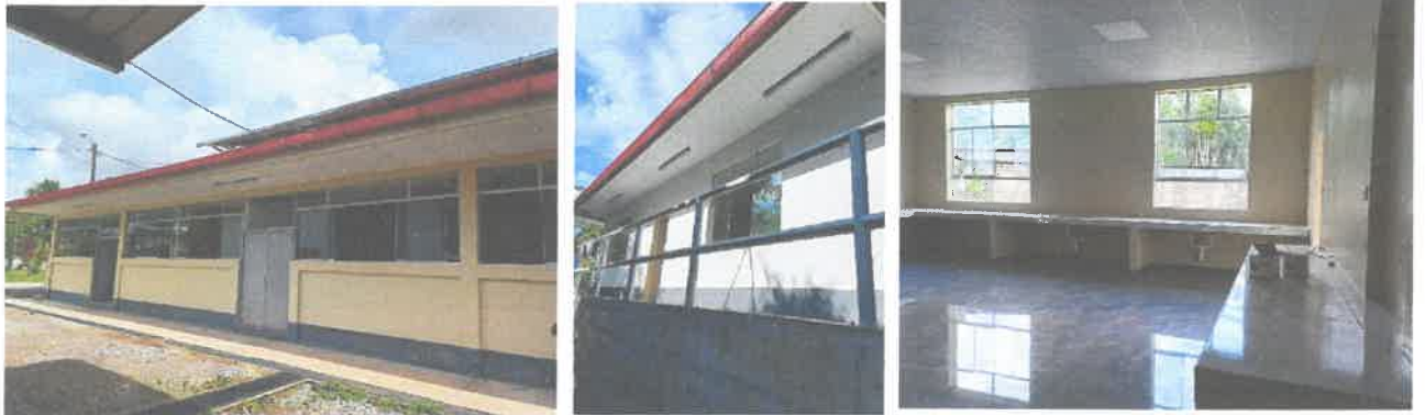
Ventanas sin protector metálico.
