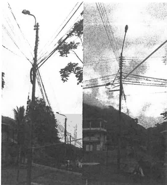
Ilustración 006: Sistema eléctrico de media tensión (Con tendido de cables eléctricos, sin cumplir con las especificaciones técnicas, del decreto Supremo N.º.020-97-EM. Norma Técnica de Calidad de los Servicios Eléctricos), en el campus universitario de la UNAS.
