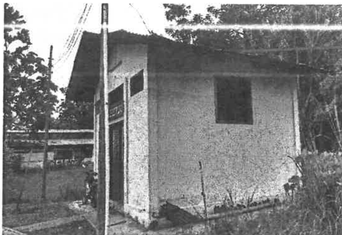
Ilustración 001: Ambiente del taller de electricidad. Parte externa (Frontal y lateral). Se puede observar el deterioro de la cobertura de calamina.
