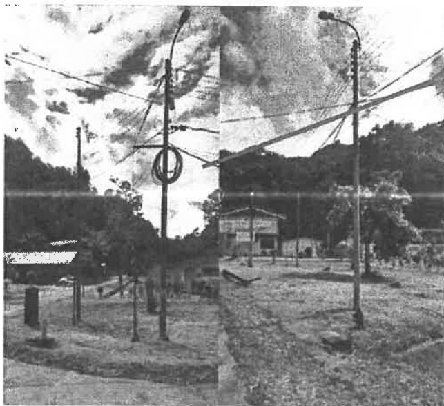
Ilustración 007: Sistema eléctrico de media tensión (Con tendido de cables eléctricos, sin cumplir con las especificaciones técnicas, del decreto Supremo N.º.020-97-EM. Norma Técnica de Calidad de los Servicios Eléctricos), en el campus universitario de la UNAS.
