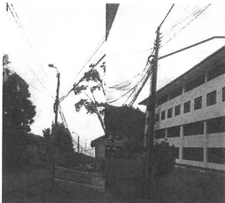
Ilustración 008: Sistema eléctrico de media tensión (Con tendido de cables eléctricos, sin cumplir con las especificaciones técnicas, del decreto Supremo N°.020-97-EM. Norma Técnica de Calidad de los Servicios Eléctricos), en el campus universitario de la UNAS.
