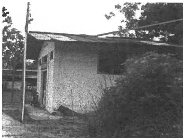
Ilustración 002: Ambiente del taller de electricidad. Parte externa (Lateral. Se puede observar el deterioro de la cobertura de calamina.
