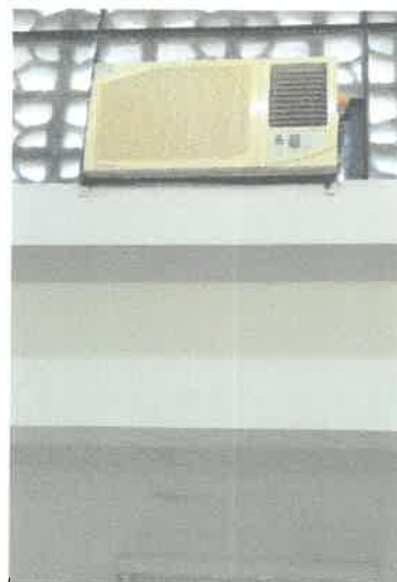
Figura 2. Equipo de aire acondicionado en columna peraltada.
